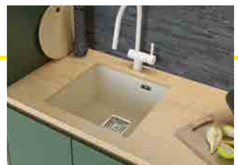
INSTALACIÓN BAJO ENCIMERA
